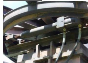
油圧ユニットの配管
