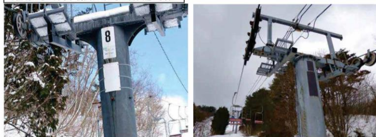
不鮮明になったり、紛失してしまった支柱の表示
